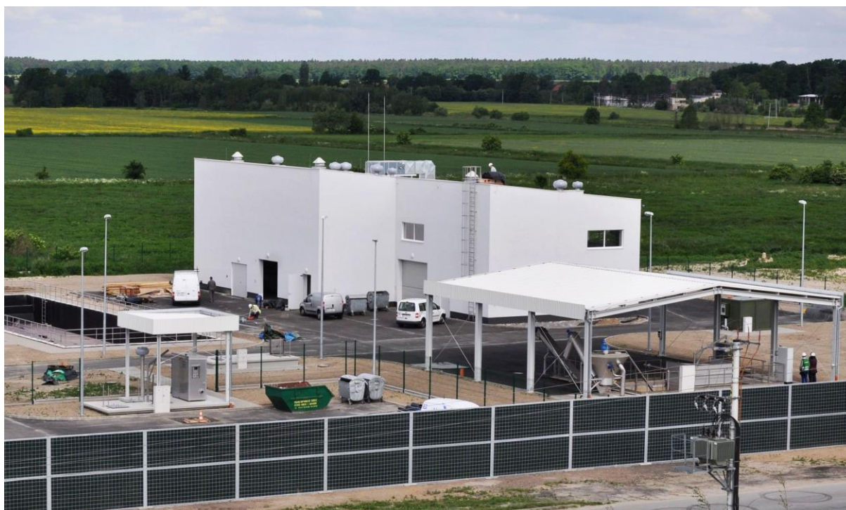
Oczyszczalnia ścieków w Ligocie Dolnej – nowa część oczyszczania mechanicznego
